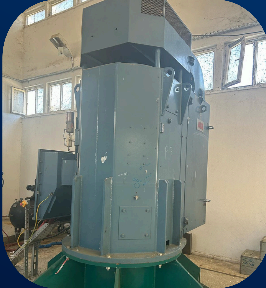
DSİ KUZOVA 1250 KW POMPA
